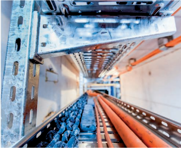
Cable de seguridad frente...
