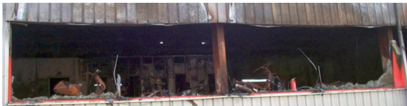
Daños de incendio por gases corrosivos
