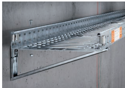
Befestigung der Kabelrinne auf Abhängewinkel AHW-T... mit Flachrundschräuben.
