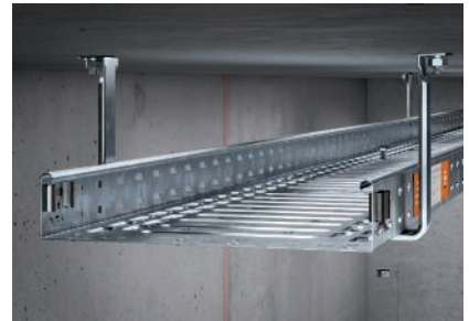
Befestigung der Kabelrinne auf Abhängebügel AHB-T... mit Flachrundschräuben.
