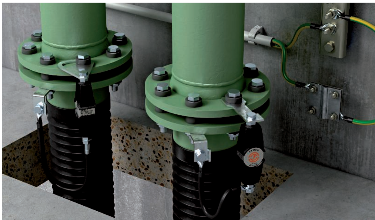
Scheidingsvonkbaan op isolatiestukken gemonteerd
