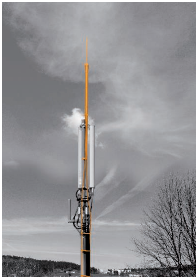
Mobiele telefoniemast met isCon®-afleiding
