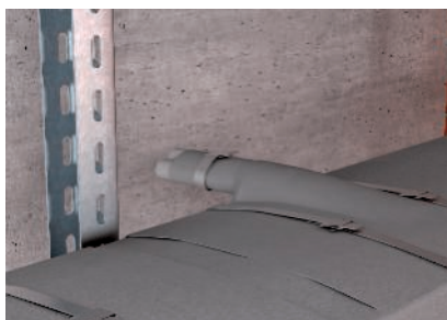
Kabelausgang mit Bandagierung.
