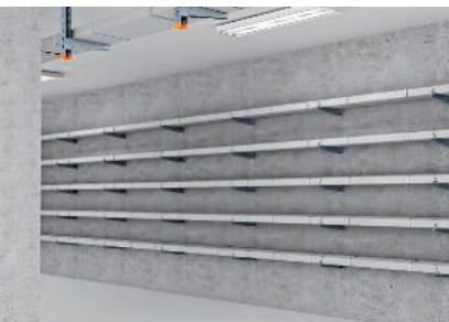
Kabeltunnel mit Bandagen in Kraftwerken.
