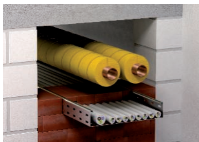
Durchgeführte nicht brennbare Rohre mit Streckenisolierung.
