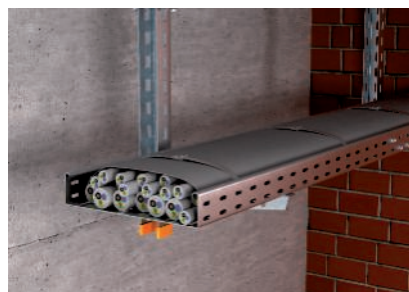
Bandagierung der Kabelbündel auf Tragsystemen.
