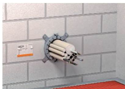
Gekennzeichnete Abschottung von Installationsrohrbündeln.
