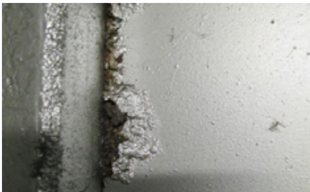
Spaltkorrosion an einer Einhausung. Durch die fortschreitende Unterrostung wird die Beschichtung beschädigt (Quelle: OBO Bettermann)
