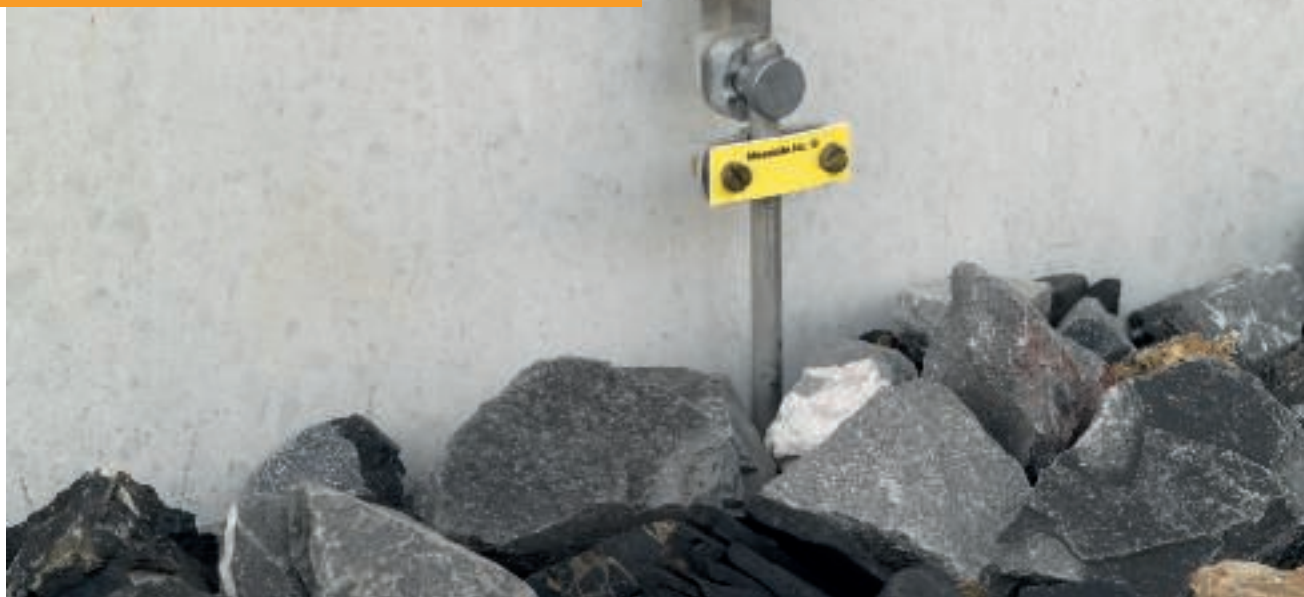
Messstelle an der Erdeinführung
