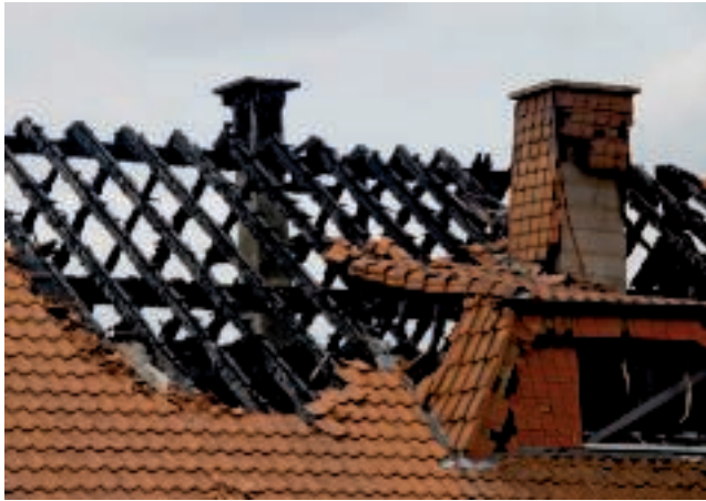
Gebäudeschäden durch direkten Blitzeinschlag
