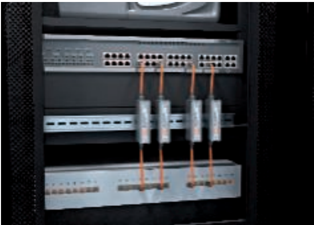
Schutzvorschlag am Switch mit Patchfeld. Die Überspannungsschutzgeräte sind über die Hutschiene geerdet.
