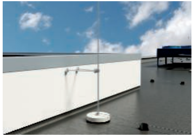
Getrennter Blitzschutz mit Isoliertraversen
