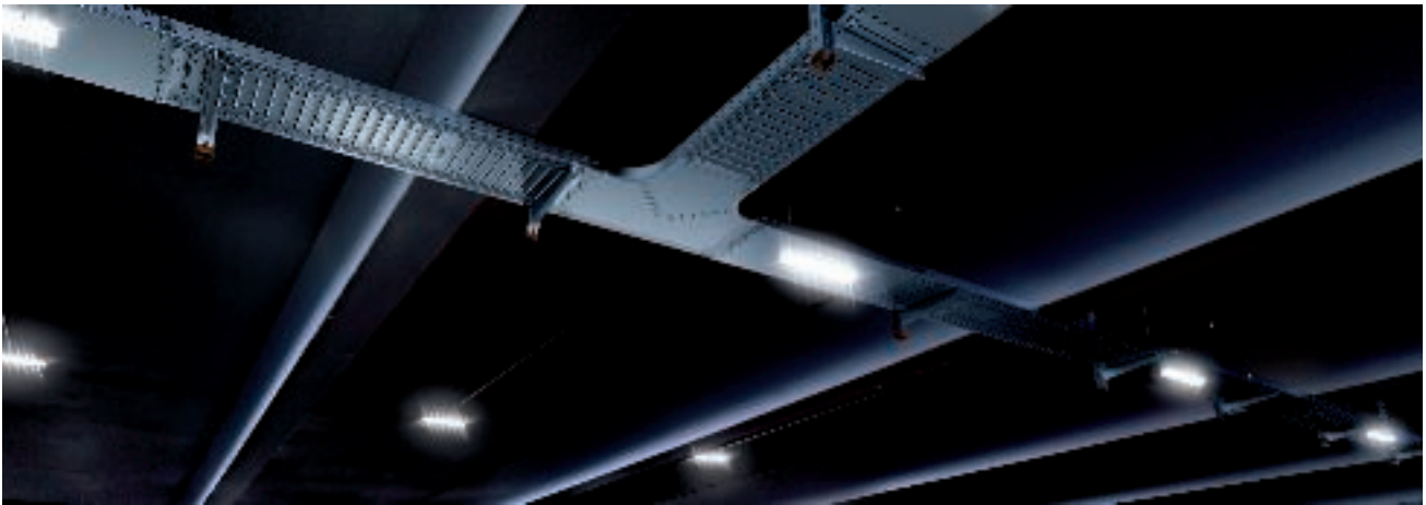
LED-Beleuchtungssystem in einem Parkhaus
