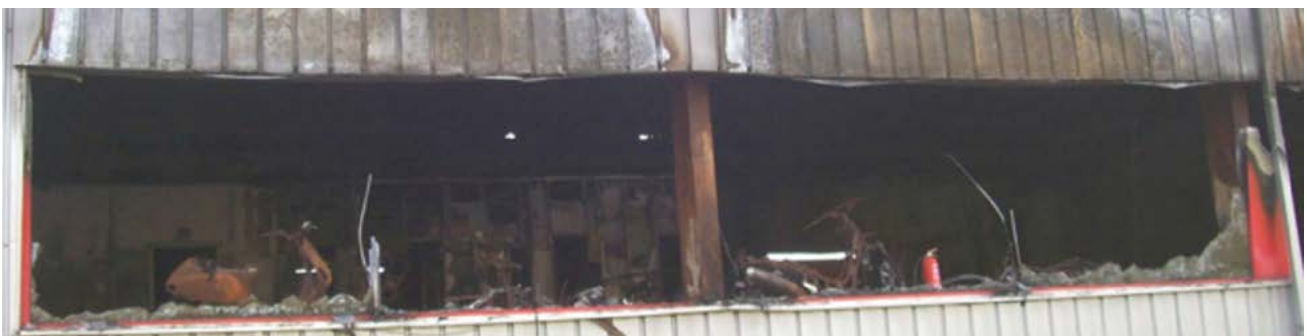
Brandschaden durch korrosive Gase
