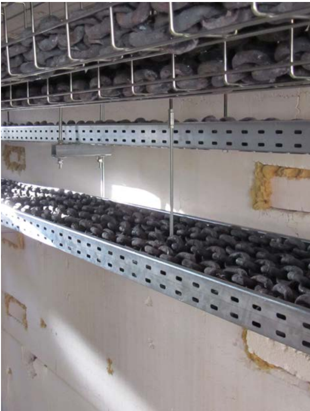
Kabelrinne mit hoher mechanischer Last vor...
