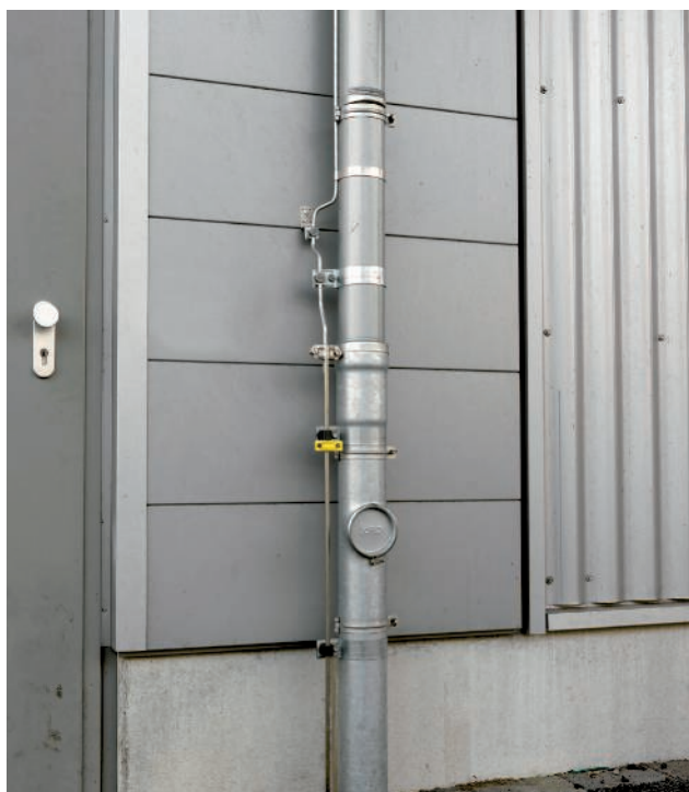
Blitzschutzableitung an einem Regenfallrohr
