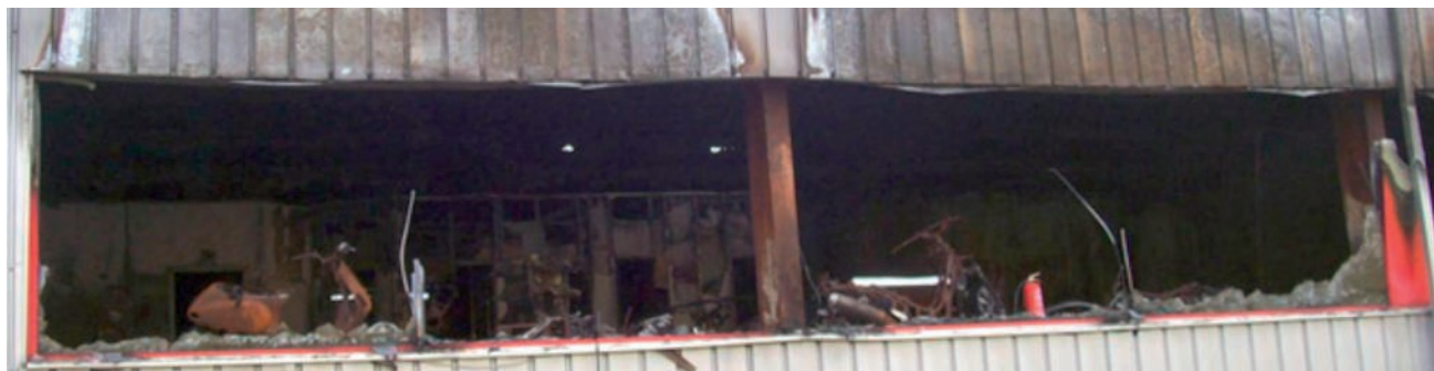
Brandschade door corrosieve gassen
