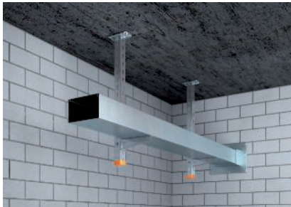
Abgehängte Montage auf Kabeltragsystem.
